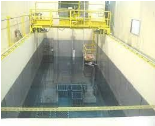
Gambar 1.5 Instalasi Penyimpanan Sementara Bahan Bakar Nuklir Bekas
